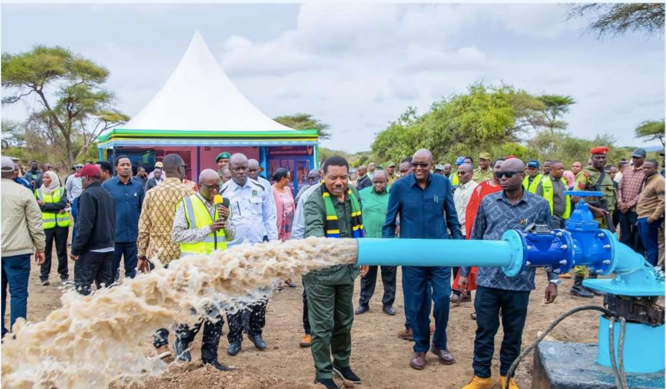
Waziri Mkuu wa Jamhuri ya Muungano wa Tanzania, Mheshimiwa Dkt. Mwigulu Lameck Nchemba (Mb), akikagua Mradi wa Maji Sinya, Wilaya ya Longido na kushuhudia kazi ya kusafisha (flushing) maji kutoka kwenye kisima
